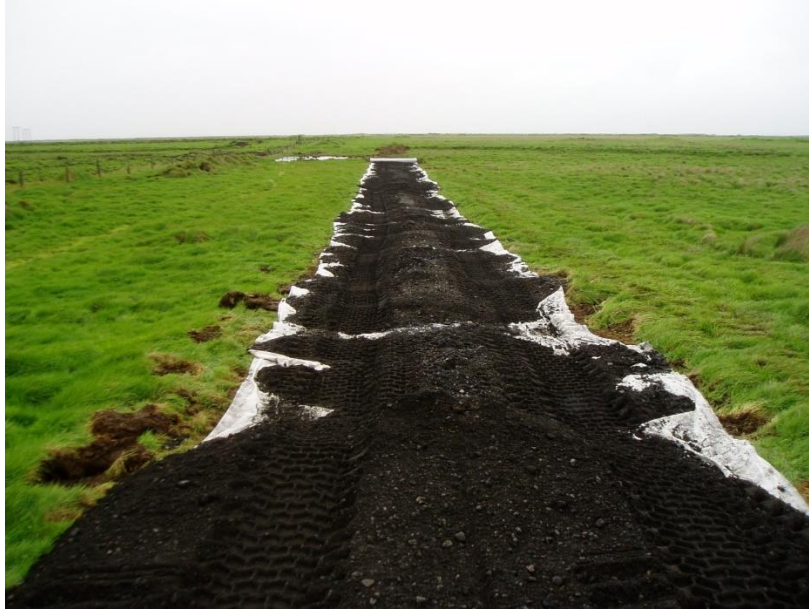
Mynd 5.4 Lagning slóða vegna jarðstrengs VM3 í móa sunnan við Rimakot, þar sem nota þurfti jarðvegsdúk.
